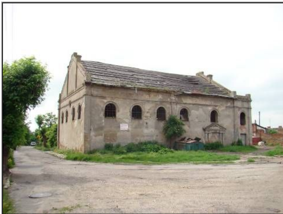
ryc. 53 Zdewastowany budynek byłej synagogi przy ul. Kilińskiego (przeznaczony do rewitalizacji)
